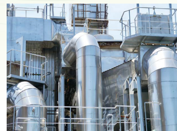
設備機器、プラント、電力室
