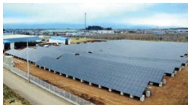
山形事業所 2013年設置 システム容量732kWh
