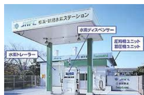
水素ステーション
